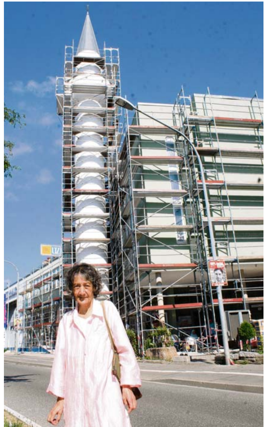
Die Moschee an der Reichenastraße muss zwölf Jahre nach der Eröffnung generalsaniert werden. Ein undichtes Flachdach verursacht hohe Kosten. Peyman Özen, Vorsitzende der Türkisch-Islamischen Gemeinde, hofft auf Unterstützung durch Spender. BILD: RINDT
